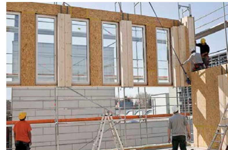
Fasadeelement monteres på LCTone i Østerrike - et kombinert betong- og massivtre bygg på 8 etasjer som ble ført opp på kun 8 dager. Ref. https://www.youtube.com/watch?v=YRtmyF5DT40 .
