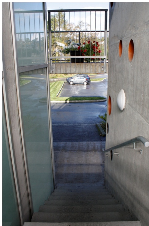
Trappen i Tertnesflaten 7, markering av trinn mangler, samt håndløper på begge sider og i to høyde
