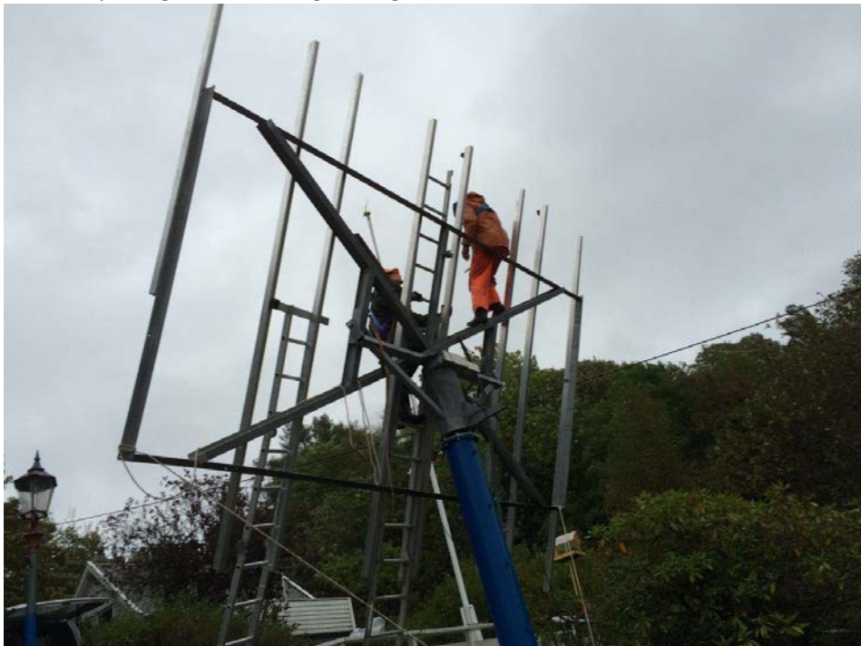
Foto: Arne Nakling. Stativet montert på mast. Solceller kommer senere
