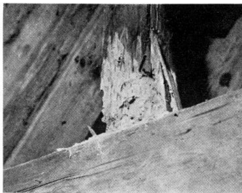
Skade i takverk.
