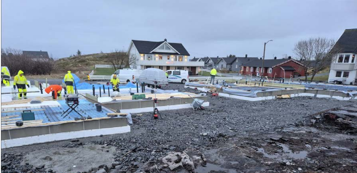
Bilde - Nordbohus er igang med fundamentering for 4 boenheter i Trænas første borettslag. (Foto: Einar Arne Lomahaug 16.12.2025)
